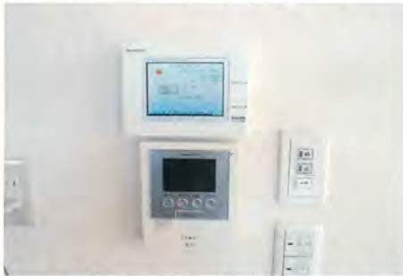
( カ ー ラ ー 液 晶 モ ニ タ 設 置 )
