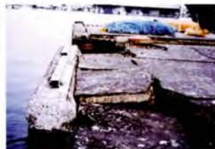
平成5年 釧路沖地震 東港区副港地区 -5.0m岸壁
