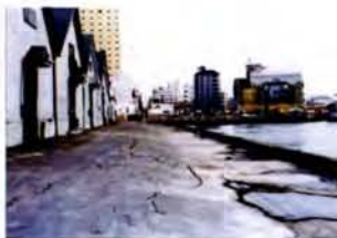
平成5年 釧路沖地震 東港区中央埠頭 物揚場
